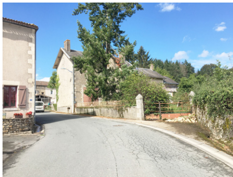
Pente importante dans la rue du Val de Miochette. Le projet tendrait à dévier les eaux de ruissellement de voirie vers la parcelle en prairie sur la droite de l'image
